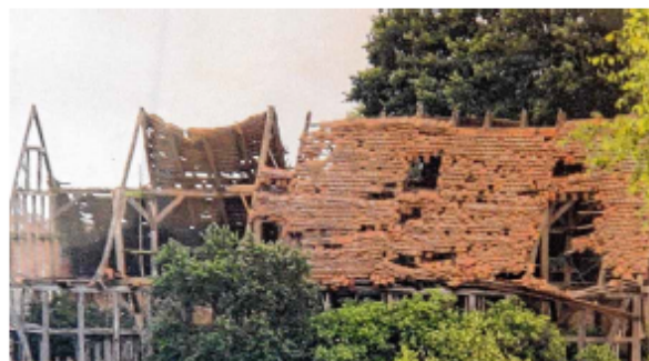
So sah die Scheune aus dem 17. Jahrhundert aus, bevor sie restauriert wurde. Die Fachwerkbalken konnten das Gebäude kaum noch stützen. Teile der Scheune waren bereits zusammengestürzt. Foto: Helmatverein
