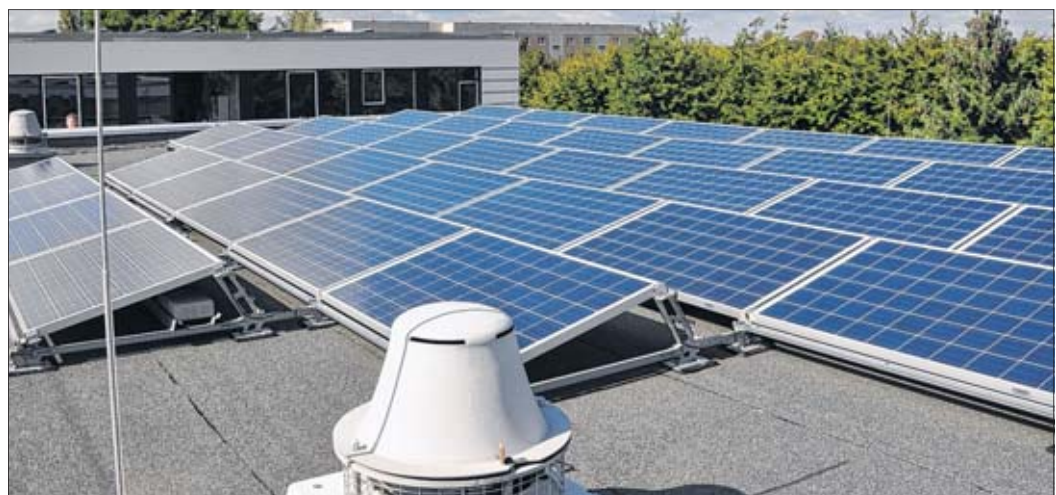
Der Anschluss der Photovoltaikanlage auf dem Dach der Schule in Elbe-Parey sorgt für Streit zwischen den Stadtwerken Burg und der Avacon. Foto: Sigrun Tausche
