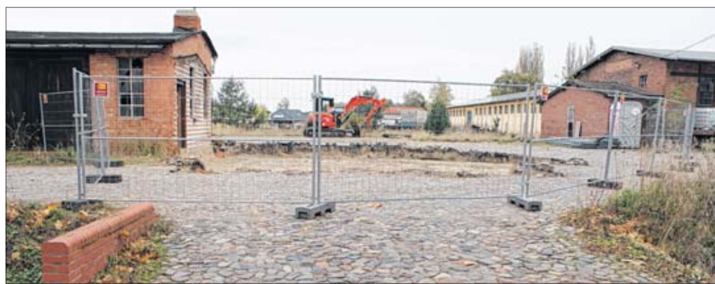
Teile des linken Schuppens am Bahnhofsgelände sind abgetragen worden. Fotos (3): Stephen Zechendorf
