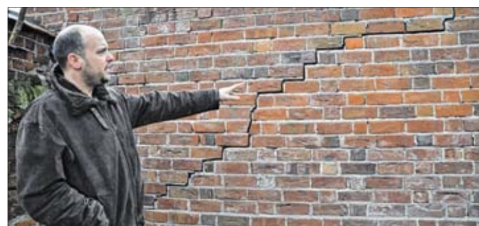
Jan Wißgott zeigt einen Riss, der sich treppenförmig durch die Mauer zieht, die vom Wasser stellenweise nach innen gedrückt wurde.
