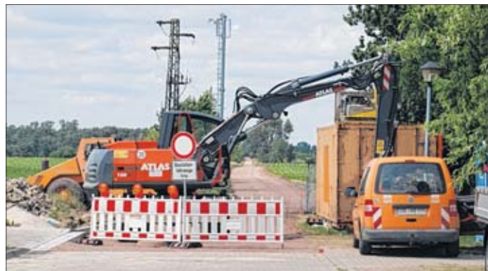
Pfützen und Sandlöcher adé: Der Weg zwischen Körbelitz und Möser wird mit Betonspurbahnen ausgebaut.
