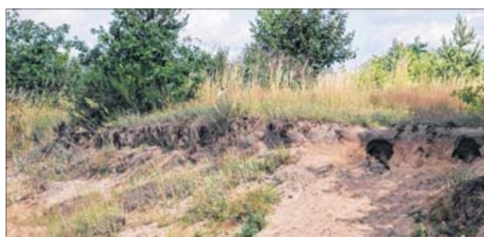
Eine große Senke ist entstanden, wo zwischen Hohenwarthe und Niegripp einst der Weg zum alten Eisenbahndamm verlief.
