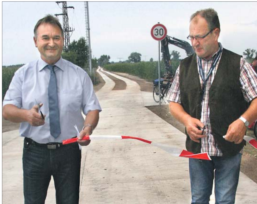
Gemeindebürgermeister Bernd Köppen (l.) und der Körbelitzer Ortsbürgermeister Eckhard Brandt schneiden das symbolische Band durch und geben somit den neuen landwirtschaftlichen Weg frei.
