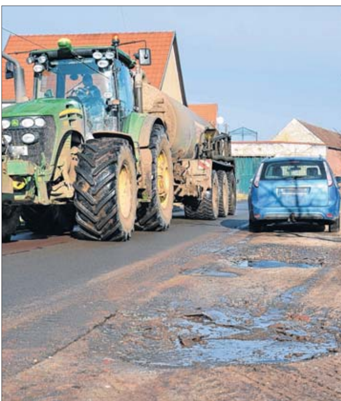
Ob Traktor, Bus oder Lkw – wenn ein größeres Fahrzeug die Genthiner Straße ortseinwärts passiert, müssen entgegenkommende Autos auf den unbefestigten Randstreifen ausweichen und damit in die Löcher hinein, die immer größer und tiefer werden. Foto: S. Tausche
