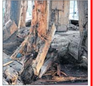
Die alten Balken im Turm waren völlig marode. Foto: privat
