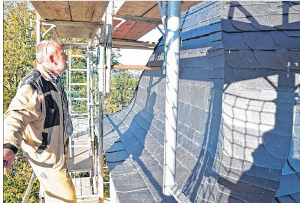
Gottfried Fritze, Mitglied des Gemeindevorstands, wohnt direkt gegenüber der Kirche und hatte die Bauarbeiten stets im Blick. Hier bewundert er die neue Schiefereindeckung des Turms. Fotos (4): S. Tausche
