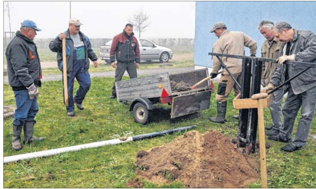
Mehrere Mitglieder des Angelvereins betonieren die Halterung für den Schiffsmast ein, der künftig symbolisch für die Schifffahrt hier vorm Elbehaus stehen soll. Fotos: Sigrun Tausche
