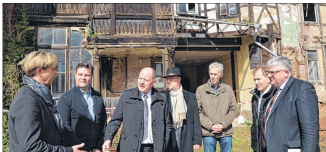
Heiko Neumann (l.) zeigte Minister Thomas Webel (3.v.l.) die marode Altbausubstanz, die das „Wohnquartier am Rolandplatz“ teurer als geplant macht. Außerdem dabei: Markus Kurze (2.v.l.), Clemens Engel (4.v.l.), Frank-Michael Ruth (3.v.r.), Marco Kelle (2.v.r.) und Lutz-Georg Berkling (r.). Foto: Steffen Reichel
